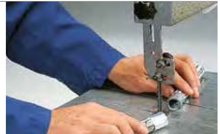
Saubere Trennung ohne Fasern durch die Umwicklung mit Metall-Klebeband Conduit ends are clean without splaying, due to adhesive tape binding
